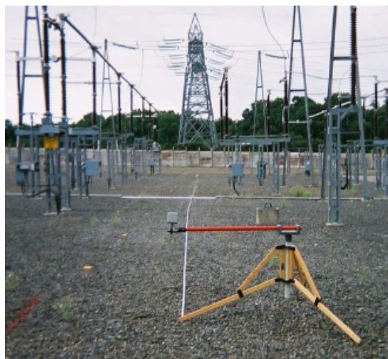
Figure 2 – Trépied isolant et support décalé d'une sonde de champ électrique (photographie RTE)
